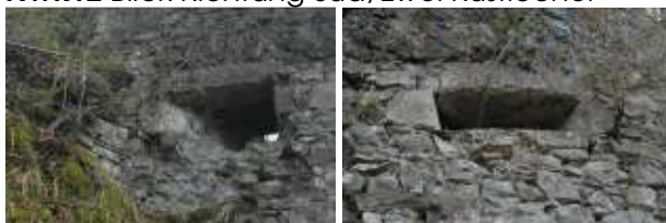
NWR06 Ausgebrochene Schießscharte sowie NWR05 im besten Zustand an der Außenseite. Dieser Ausbruch hängt vermutlich mit einer Beschusszerstörung in Zusammenhang. Möglicherweise wurde der Tuffstein beim Abbruch der Burganlage geborgen, Foto 2005.
